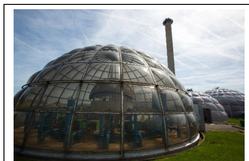
Géothermie Énergie Meaux alimentant le réseau de chaleur de la Ville de Meaux (77)
